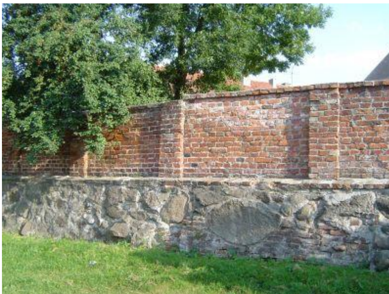
Ilustracja 7. Sulechów. Pozostałości po ścianach nieistniejących już budynków - obecnie ulica Okrężna.
